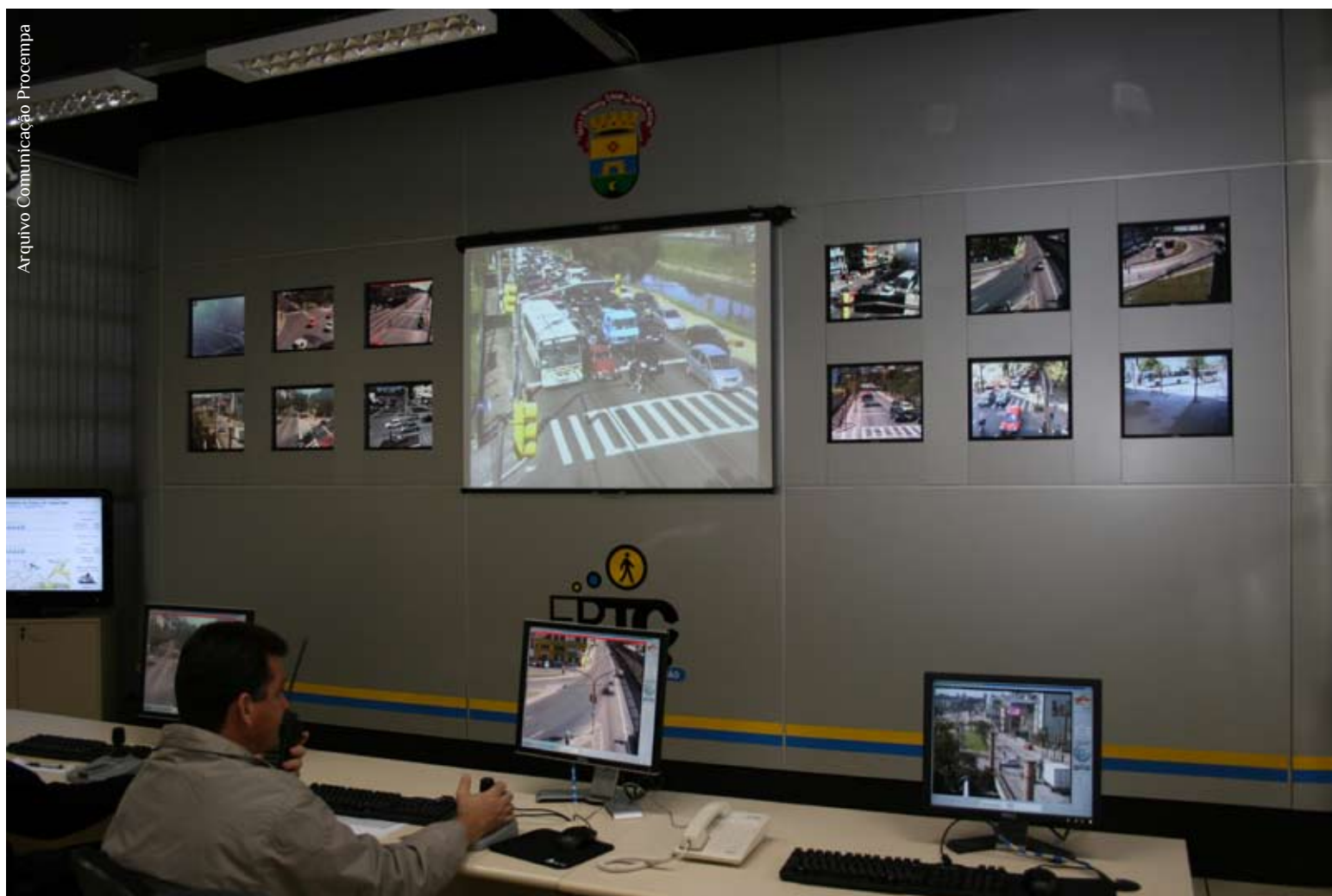
Nova central com agentes dedicados exclusivamente ao monitoramento das imagens
