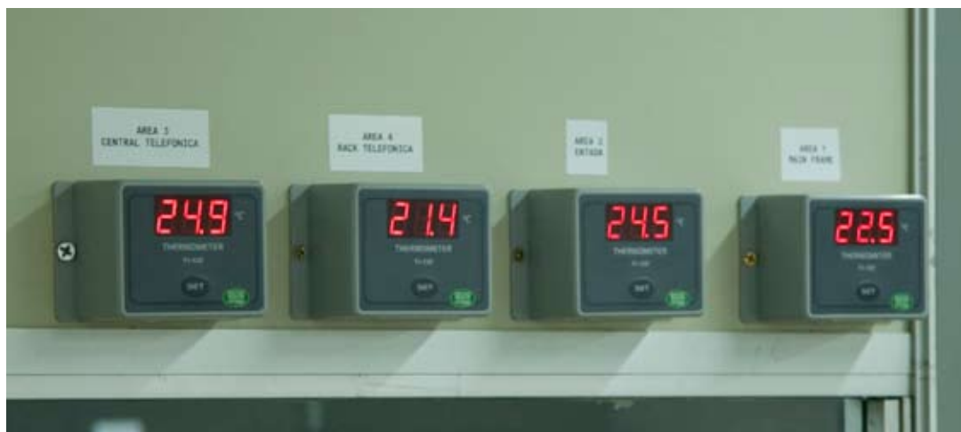
Distribuição de ar controlada para manter a temperatura ideal
